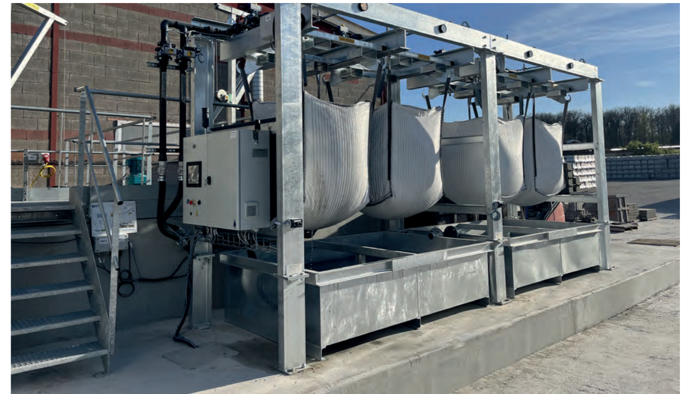
Wasseraufbereitungsanlage (an unseren drei Standorten)
