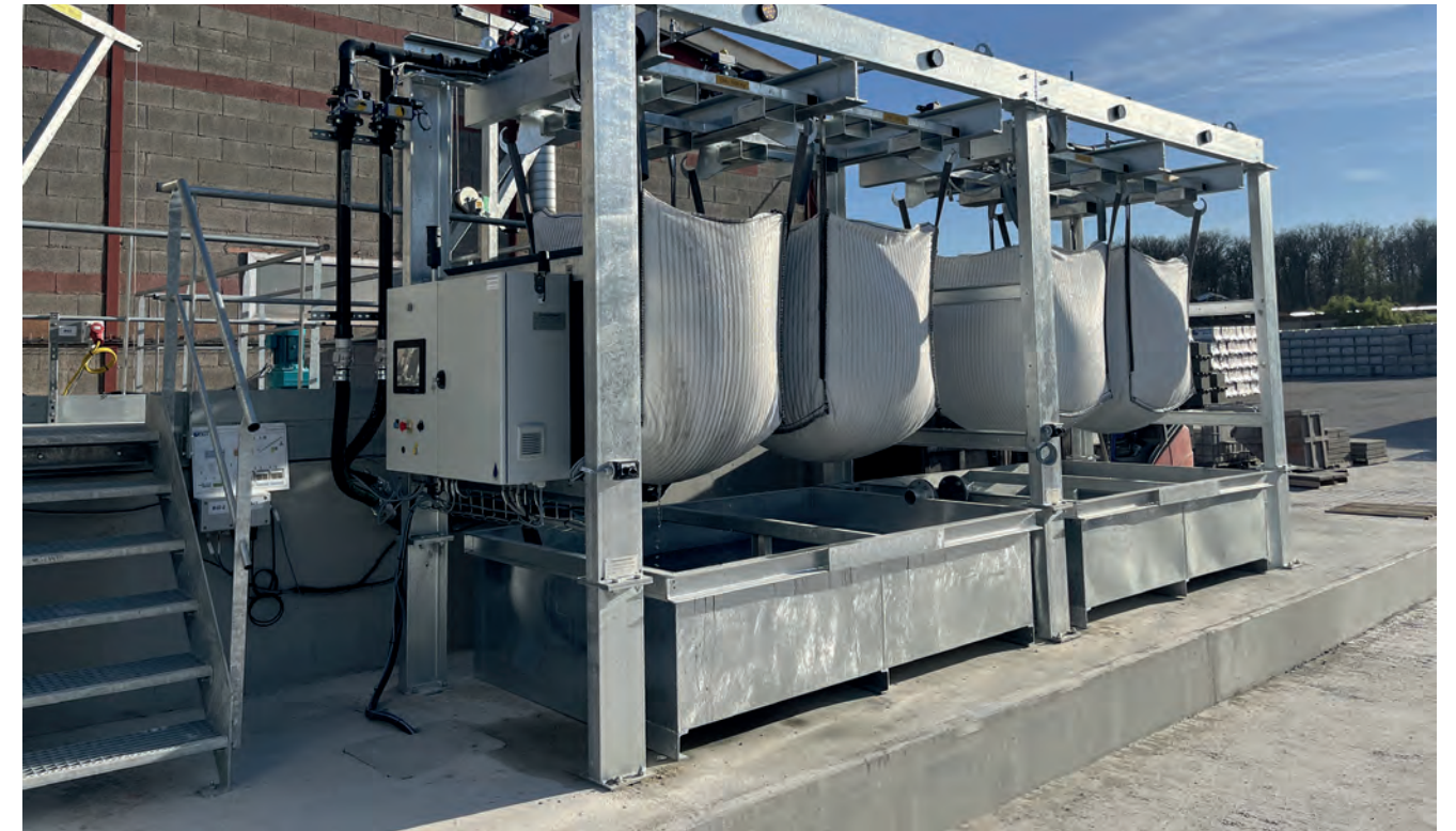
Wasseraufbereitungsanlage (an unseren drei Standorten)
