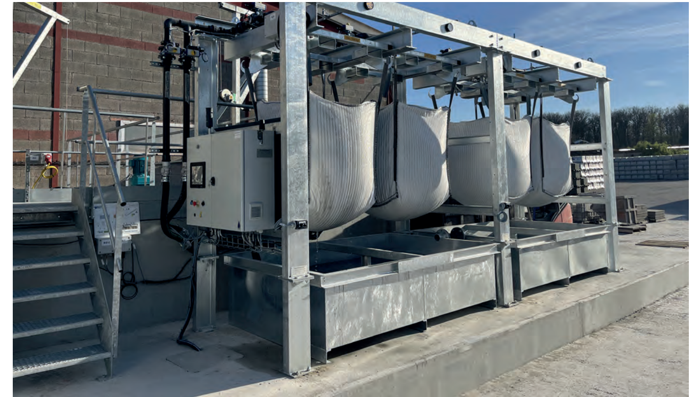
Station de traitement des eaux (sur nos trois sites)
