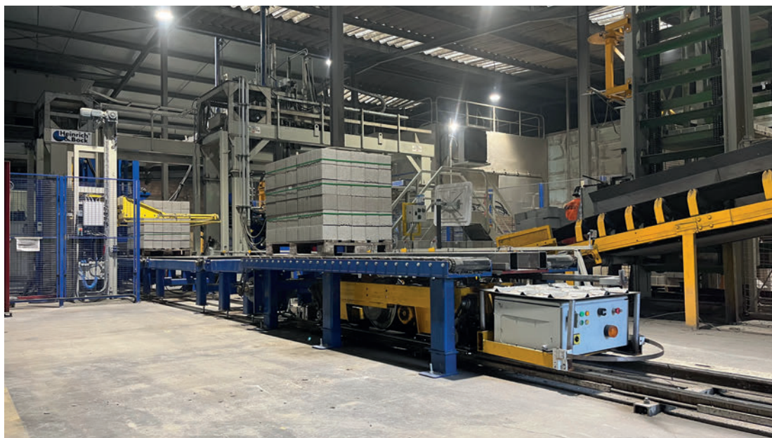
Ligne d'évacuation des palettes
